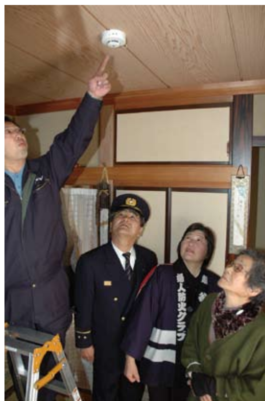
婦人防火クラブ員と住宅用火災警報器の設置指導
