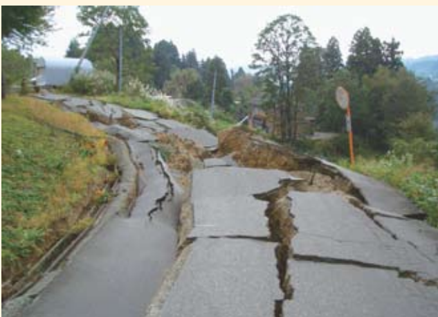
小千谷市内の道路状況
