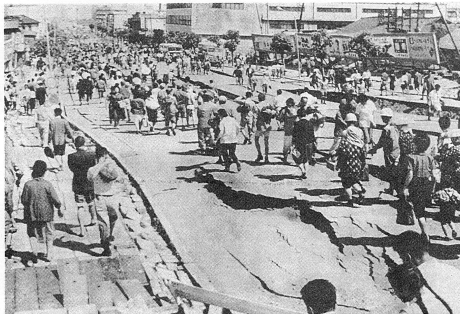
いままでバスで快適にかよった道もジグザグに、あるいはパクリと口をあけ、車も走れない惨状（新潟日報社発行「新潟地震の記録」から）
