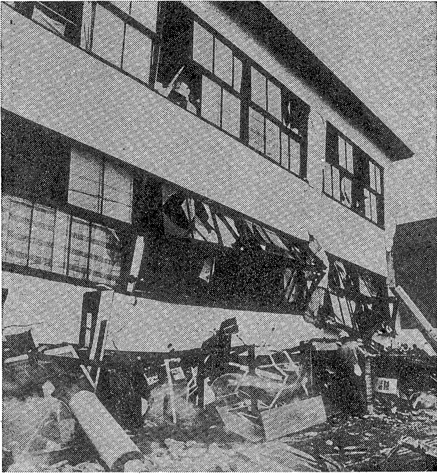
壁や柱が少ないため一階がつぶれた建物
