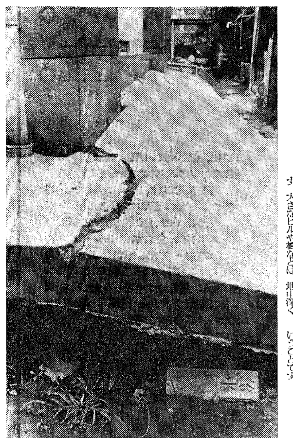
地盤沈下のため、20センチもあるコンクリートの犬走りが割れてしまった(越谷北高等学校で)
