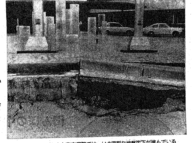
51年にオープンした市立病院では、いま深刻な地盤沈下が進んでいる
