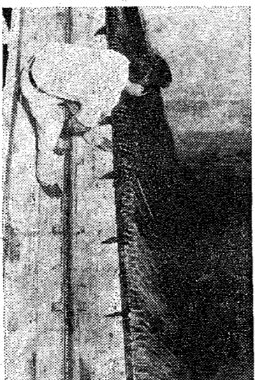
住宅地や道路にたまった雨水や雑排水はポンプ場に導かれ、この大きなスクリーンで障害物が除かれます
