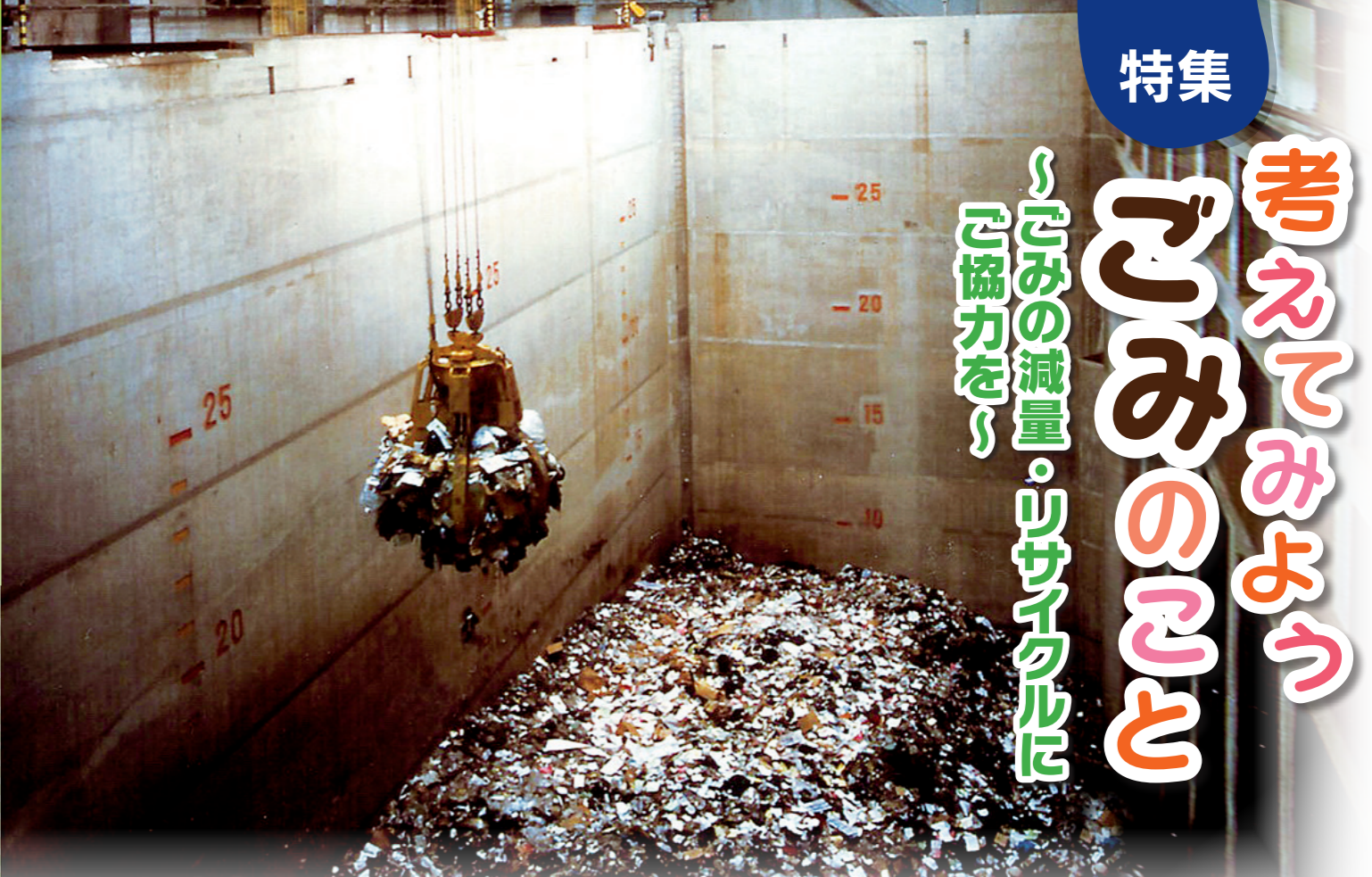
▲約1万トンのごみが溜められるごみピットの様子。燃えるごみは東埼玉資源環境組合第一工場のごみピットに集められ、巨大なクレーン(1つかみ約2~3ト)で、ごみが安定して燃えるようにかき混ぜてから、焼却炉へ運ばれます
