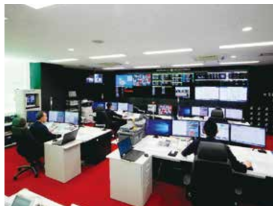
現在の越谷市消防指令センター
