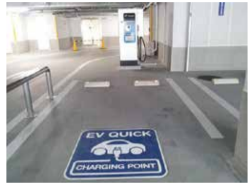
市内の駐車場に設置されている急速充電設備
