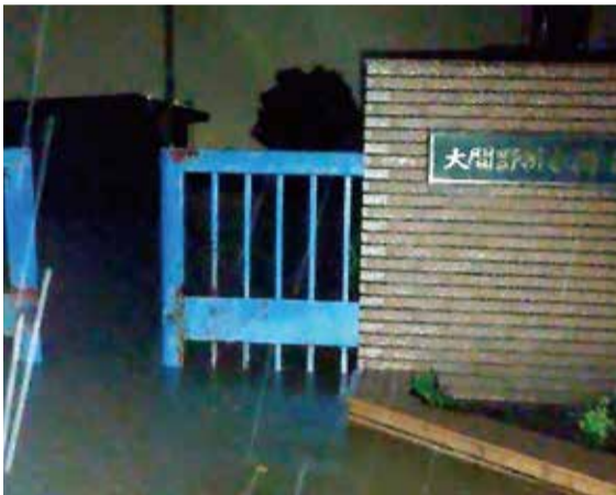
台風2号により冠水した大間野排水機場の様子(夜間撮影)
