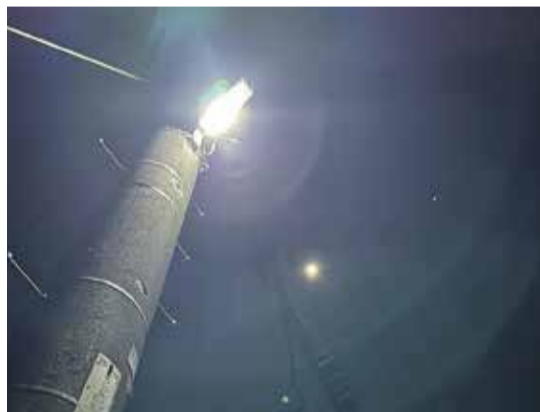
市民の安心安全を見守る道路照明灯
