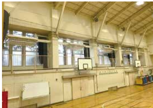
屋内運動場の空調設備(大袋北小学校)
