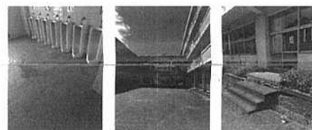
『老朽化した校舎』
