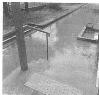
大雨で水没する外階段付近
