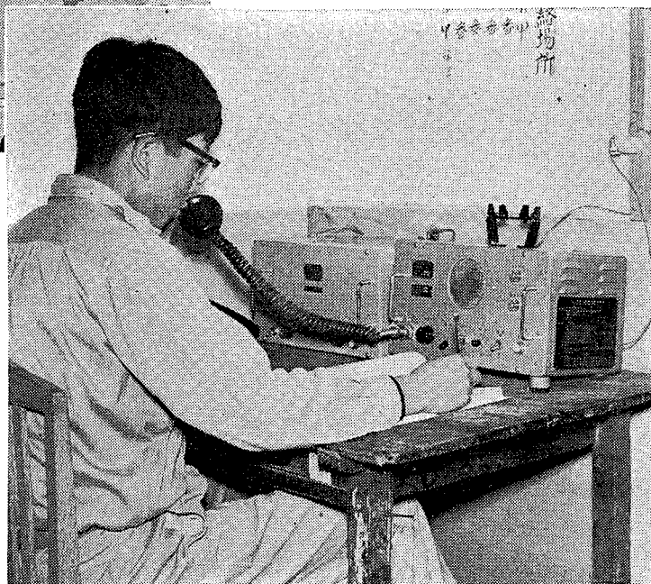
→消防署内に設置された無線器
