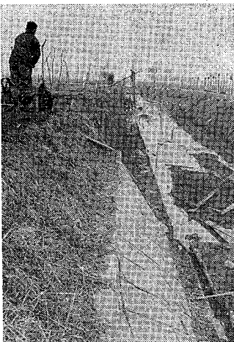
← 萩島から越巻に通ずる長島幹排の護岸工事中、護岸延長八一四米、工費は一、四七〇万円、(台風四号の災害復旧工事)
