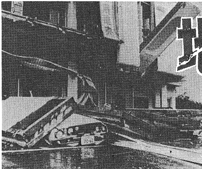
コンクリートパネルが倒壊し、自動車を押しつぶす 昭和53年6月宮城県沖地震で (財)国書刊行会編『写真・図説 地震』から
