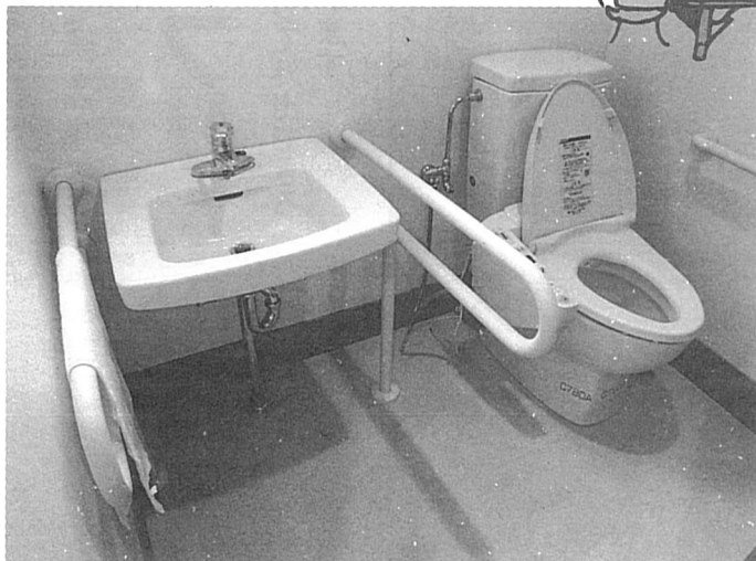
どなたでも安心してご利用いただけるようトイレにも手すり等が設置されています
