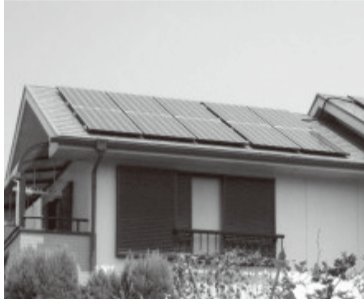
補助金を利用して設置された住宅用太陽光発電パネル
