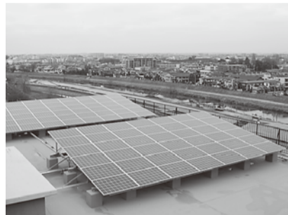
市役所第二庁舎の太陽光発電施設
