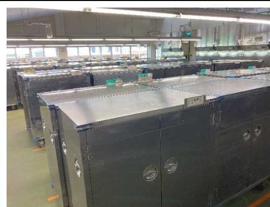
⑥ コンテナ室
