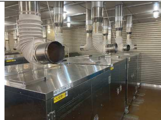
⑥ コンテナ消毒保管庫
