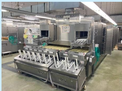
洗浄室(食器洗浄機)
