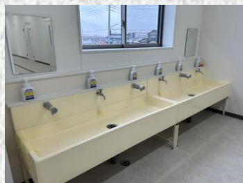
↑ 自動水栓付手洗い流し
