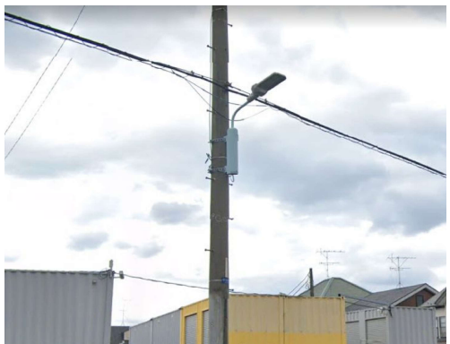
図 1-6 道路照明灯（共架）
