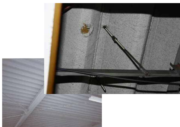
レベル2: 屋根用折板石綿断熱材
