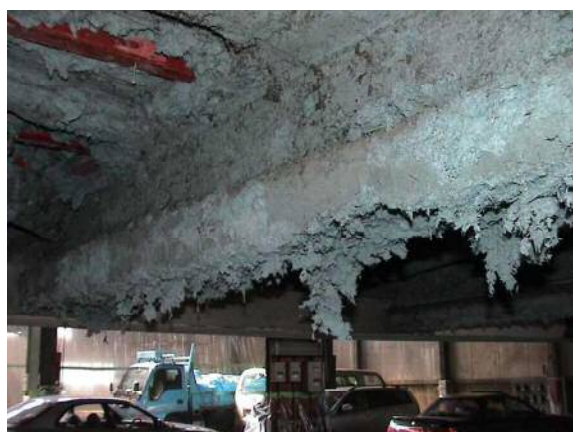
レベル1: 吹付け石綿(クロシドライト)
