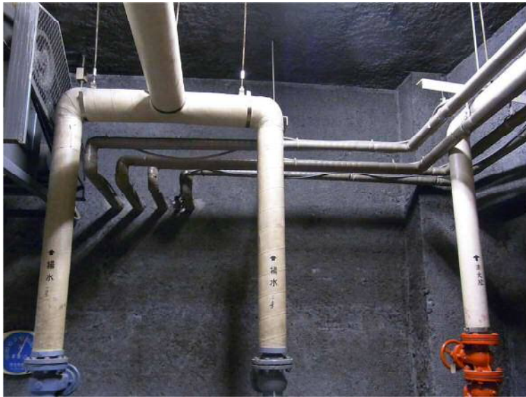
①吹付け石綿(クロシドライト)
