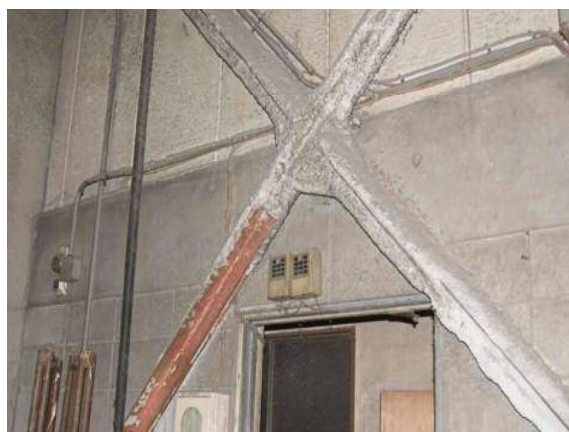
レベル1: 吹付け石綿(クリソタイル)
