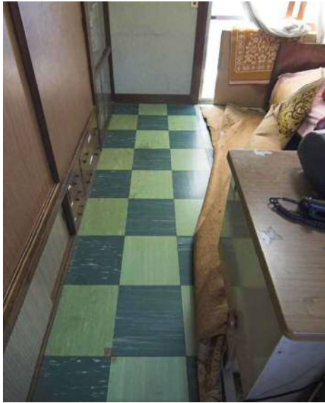
①石綿含有ビニル床タイル
