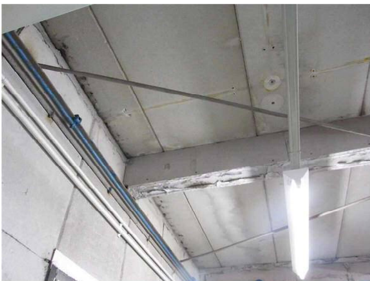
③石綿含有耐火被覆塗り材
