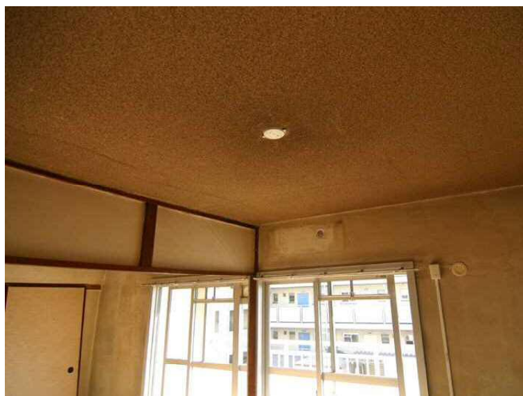
③石綿含有吹付けバーミキュライト (ひる石吹付け材)
