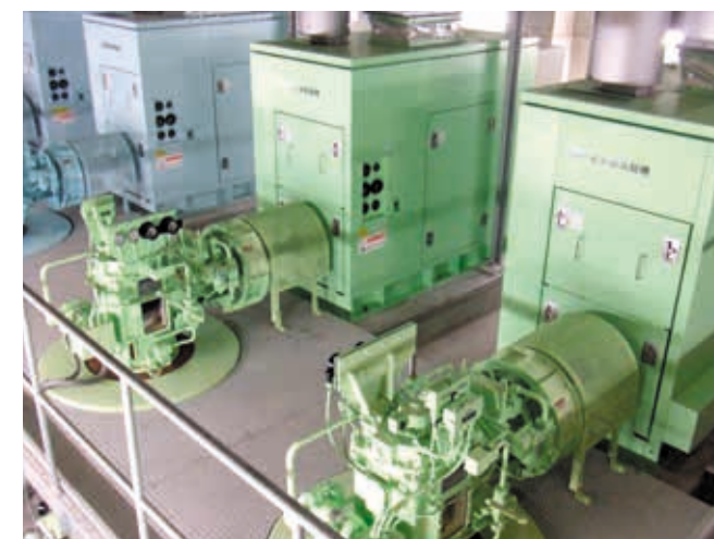
大相模調節池排水機場
