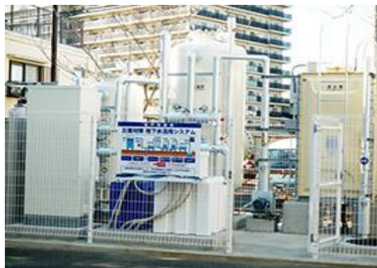
■イメージ例:地下水膜ろ過システム／松戸市
