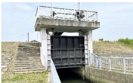
治水対策のため河川の堤防などに設置されている樋管
