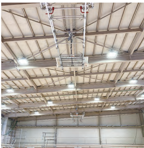
屋内体育館に設置したLED照明
