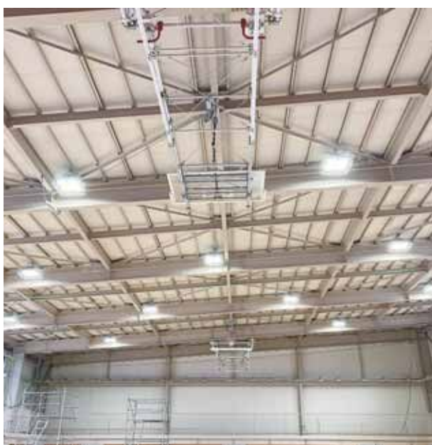
屋内体育館に設置したLED照明
