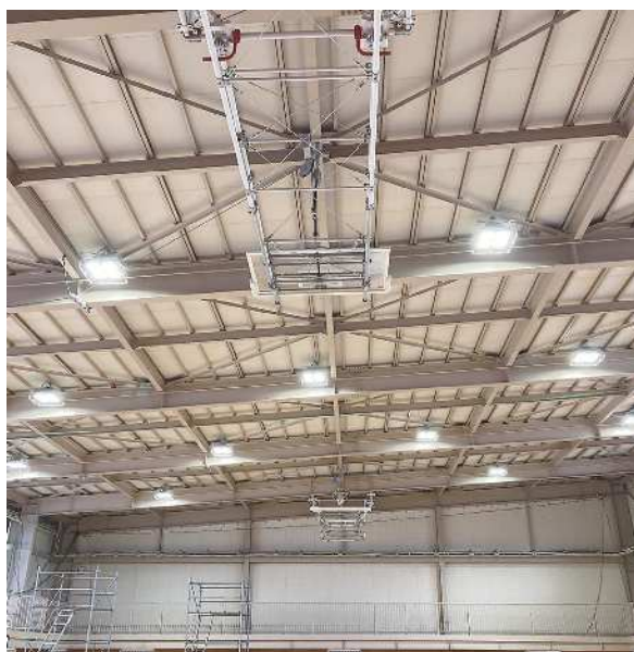
屋内体育館に設置したLED照明
