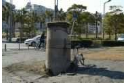
液状化によるマンホール浮上
