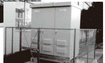
太陽光発電設備と蓄電池
