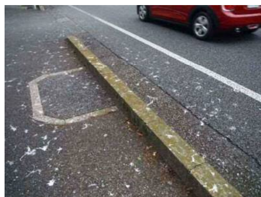
対策前の糞で汚れた道路
