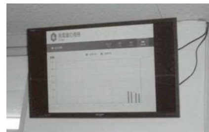
発電表示モニター
