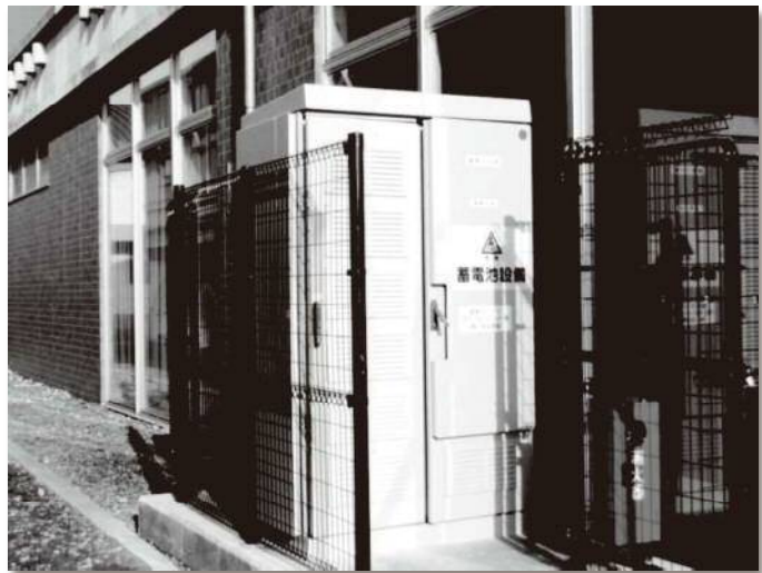
平成 27 年度に設置された太陽光発電設備と蓄電池（消防本庁舎）
