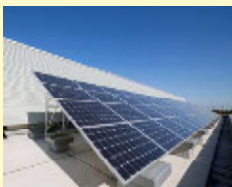
■保健所太陽光発電パネル
