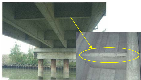
コンクリート桁橋(剥離・鉄筋の露出)
