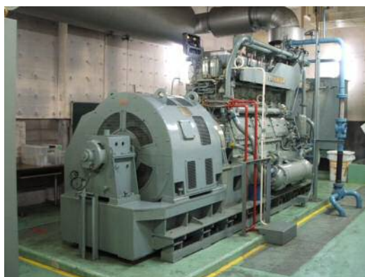
■イメージ例：非常用自家発電設備／滋賀県
