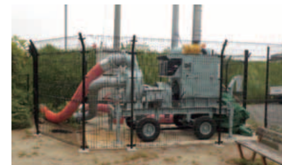
移動式排水ポンプ(平成29年設置)
